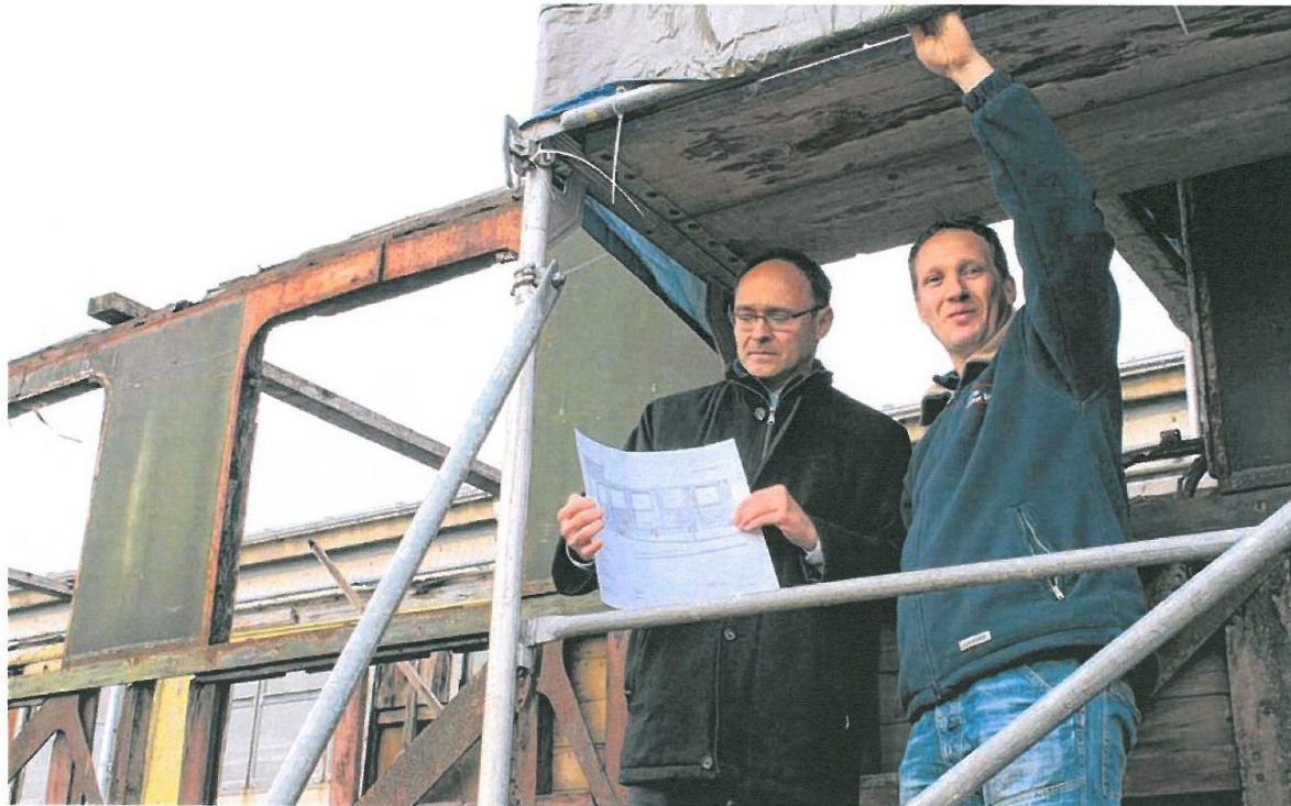
Eisenbahnxperte André Marks (li.) und der Radebeuler Dachdeckermeister Ralf Burgold bei der Prüfung der Wagenschäden.
